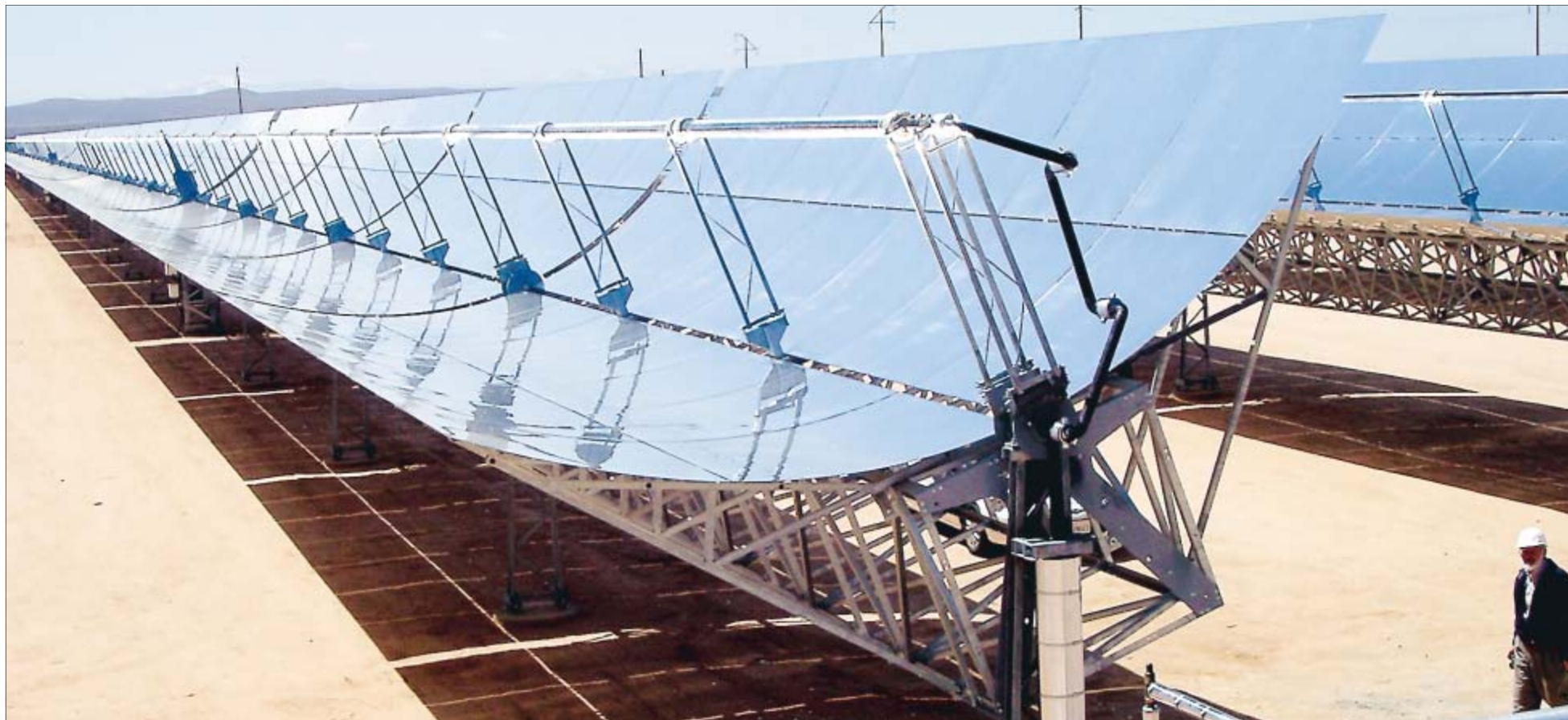
Das Solarthermiekraftwerk Andasol 3 im spanischen Andalusien ist ein Versuchskraftwerk für das riesige Desertec-Projekt in Nordafrika und im Nahen Osten.
